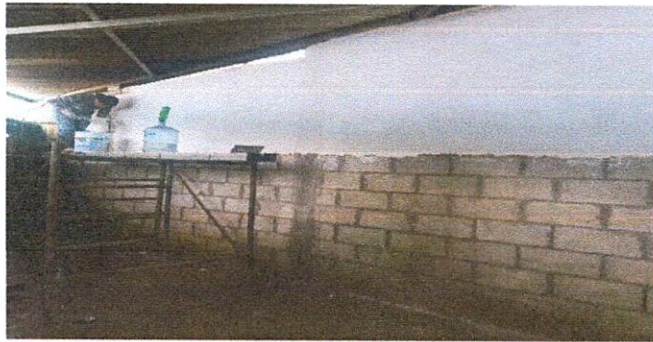
Foto 3: Repello, cernido en paredes de la cocina, en el interior y exterior
