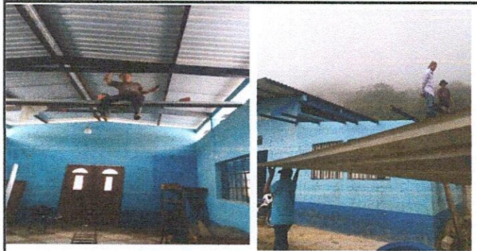
Foto1: Sustitucion de techo del establecimiento y mantenimiento de la estructura de soporte de metal.
